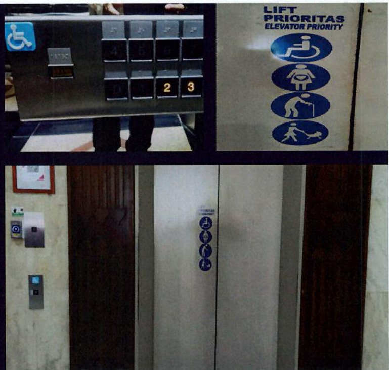
Gambar Lift Difabel Akses Menuju Ruang Layanan PPID Sekto Administrasi Jakarta Pusat
